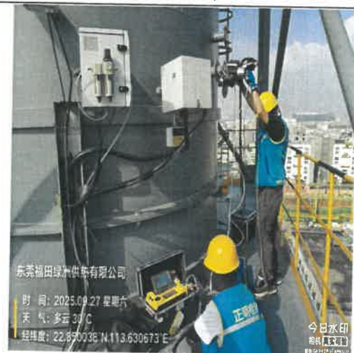
锅炉废气排放口
